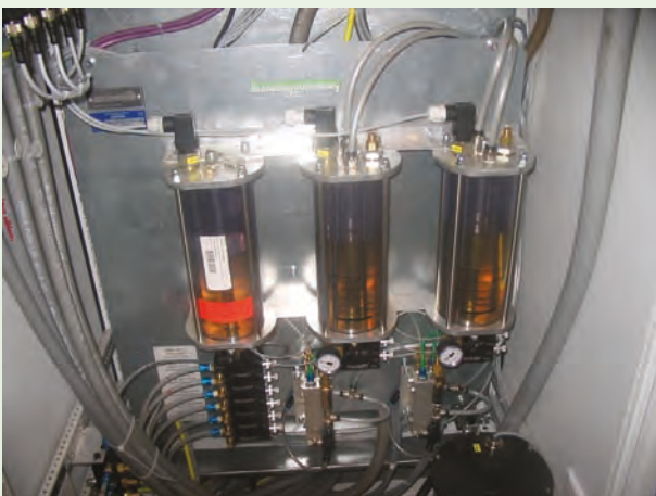
6 Pumpen für Außenschmierung 4 Pumpen für Innenschmierung
